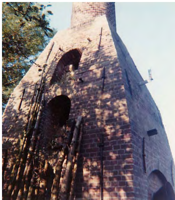
Oostzijde van de pijpenoven Weert met de vulopeningen van de 2e en 3e bakruimte. Noordzijde met takelhaak.
